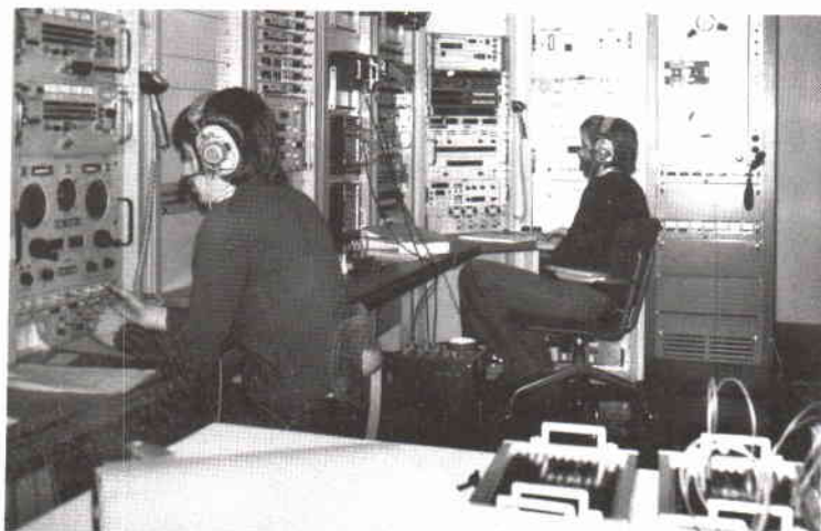
Datacentralen för telemätssystemet
